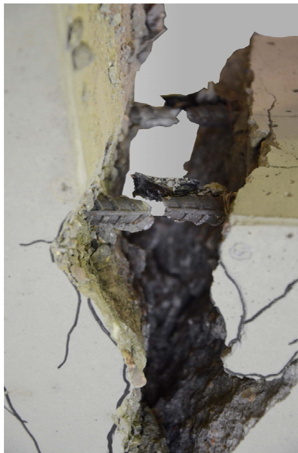
Pręty zbrojenia głównego zerwane podczas badania Main reinforcement bars were ruptured during test
