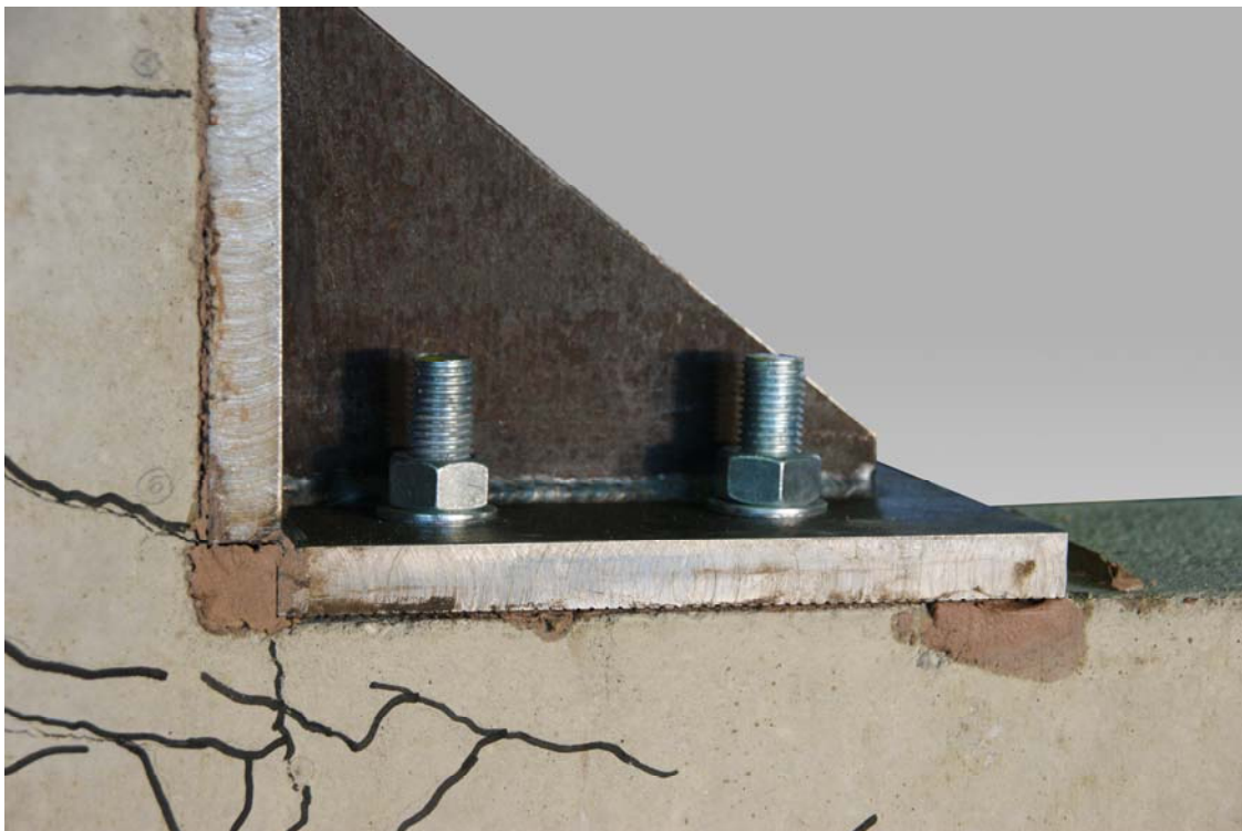
Poślizg pomiędzy stalowym akcesorium a powierzchnią betonu Slip between steel accessory and concrete surface
