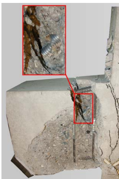
Rys. 3.20. Widok zerwanego ukośnego pręta wzmacniającego w elemencie C-II Fig. 3.20. View of ruptured diagonal strengthening rod in corbel C – II
